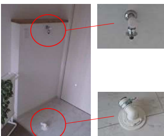
■洗濯用給排水
