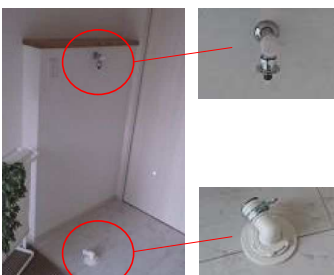
■洗濯用給排水
