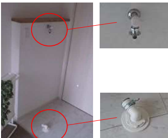
■洗濯用給排水
